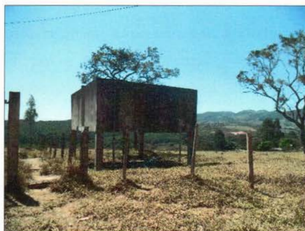
FIGURA 18 - RESERVATÓRIO R1 - DISTRITO DE SERRA DO CAMAPUÃ (FONTE: ACERVO PESSOAL, 2014).
