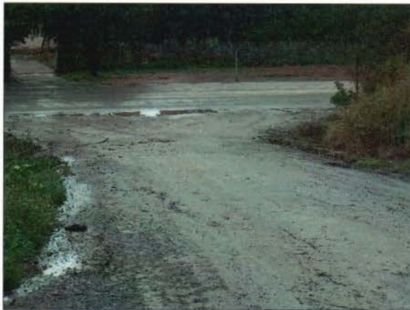
FIGURA 83 - VIA DESPROVIDA DE EQUIPAMENTOS DE DRENAGEM NA SEDE (FONTE: ACERVO PESSOAL, 2014).
