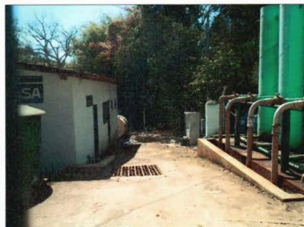
FIGURA 25 - EEAT ANEXO A ETA MORRO GRANDE (FONTE: ACERVO PESSOAL, 2014).
