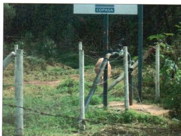
FIGURA 10 - CAPTAÇÃO NO POÇO E-02 - VISTA 2 (FONTE: ACERVO PESSOAL, 2014).
