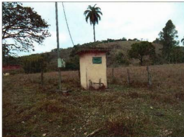
FIGURA 37 - CAPTAÇÃO SUBTERRÂNEA NA LOCALIDADE DE COLÔNIA - VISTA 1 (FONTE: ACERVO PESSOAL, 2014).
