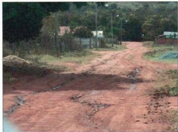
FIGURA 53 - ESGOTO A CÉU ABERTO - VISTA 2 (FONTE: ACERVO PESSOAL, 2014).
