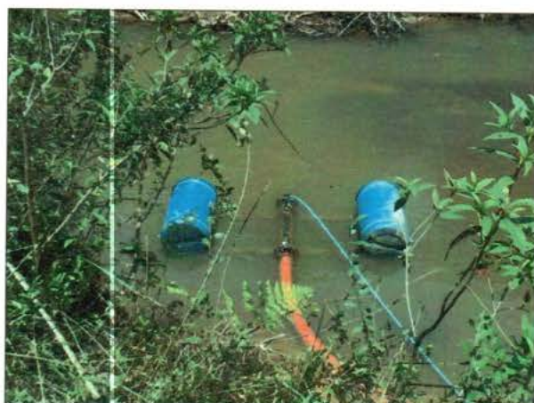
FIGURA 7 - CAPTAÇÃO NO RIO BRUMADO - VISTA 1 (FONTE: ACERVO PESSOAL, 2014).
