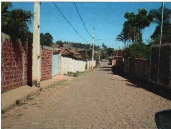
FIGURA 85 - VIA DESPROVIDA DE EQUIPAMENTOS DE DRENAGEM NO BAIRRO DE CASTRO (FONTE: ACERVO PESSOAL, 2014).
