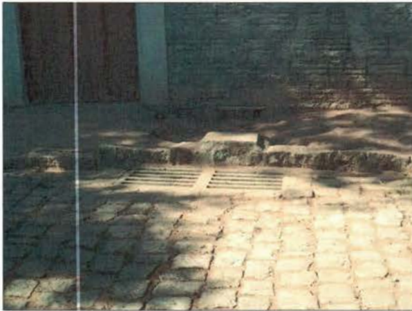
FIGURA 79 – BOCA DE LOBO NO BAIRRO CASTRO (FONTE: ACERVO PESSOAL, 2014).
