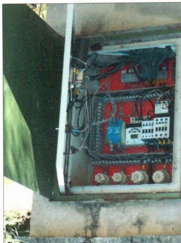
FIGURA 45 – PAINEL DE COMANDO (FONTE: ELABORADO PELO AUTOR, 2014).
