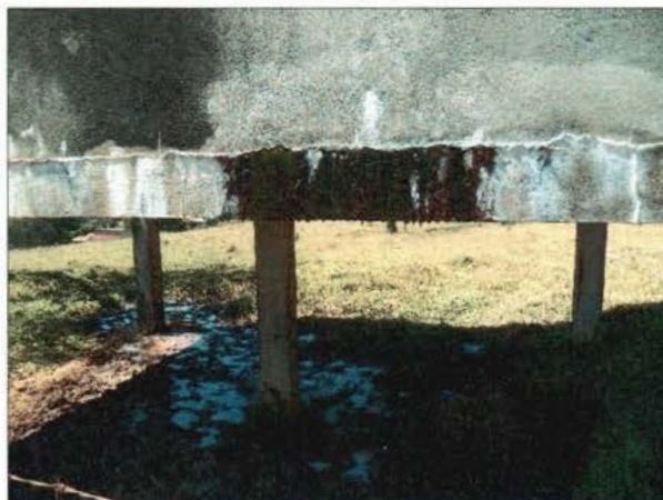
FIGURA 19 - RESERVATÓRIO COM TRINCAS (FONTE: ACERVO PESSOAL, 2014).
