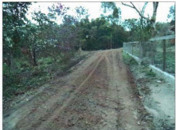
FIGURA 86 - VIA DESPROVIDA DE EQUIPAMENTOS DE DRENAGEM NA LOCALIDADE DE BEM QUERÊNCIA (FONTE: ACERVO PESSOAL, 2014).
