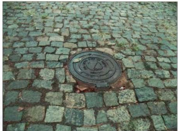
FIGURA 82 – POÇO DE VISITA NA LOCALIDADE DE SÃO JOSÉ DAS MERCÊS (FONTE: ACERVO PESSOAL, 2014).
