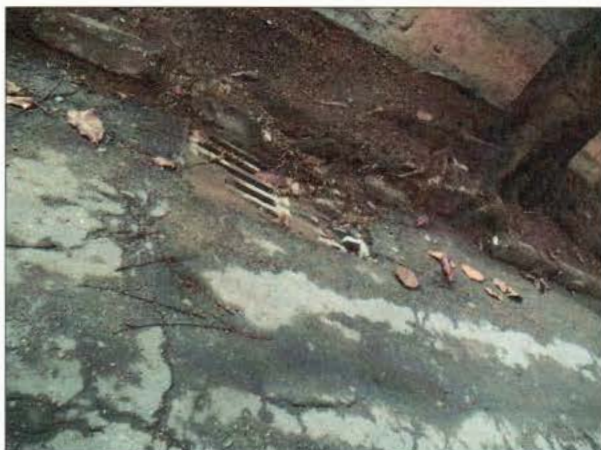
FIGURA 77 - BOCA DE LOBO COM PROBLEMA DE LIMPEZA NO DISTRITO-SEDE (FONTE: ACERVO PESSOAL, 2014).
