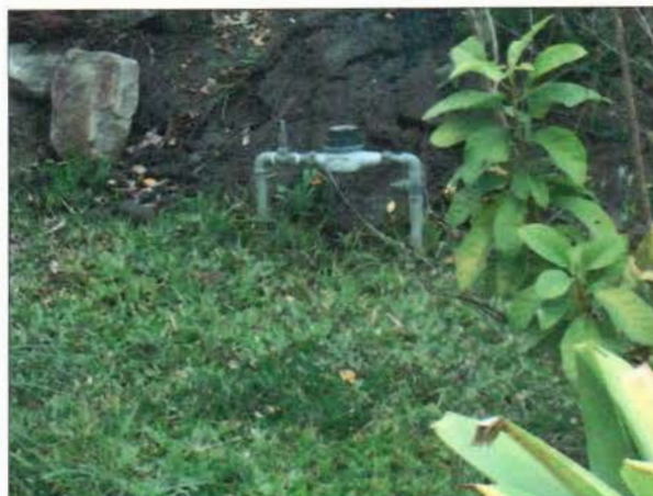
FIGURA 42 - HIDRÔMETROS NA LOCALIDADE BEM QUERÊNCIA (FONTE: ACERVO PESSOAL, 2014).
