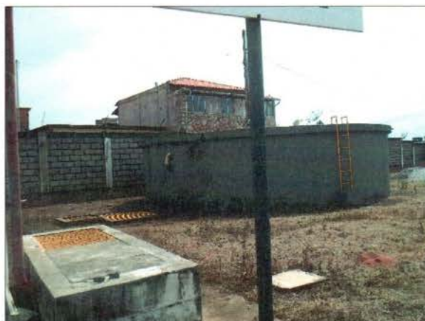
FIGURA 15 - VISTA DO RESERVATÓRIO R4 (FONTE: ACERVO PESSOAL, 2014).
