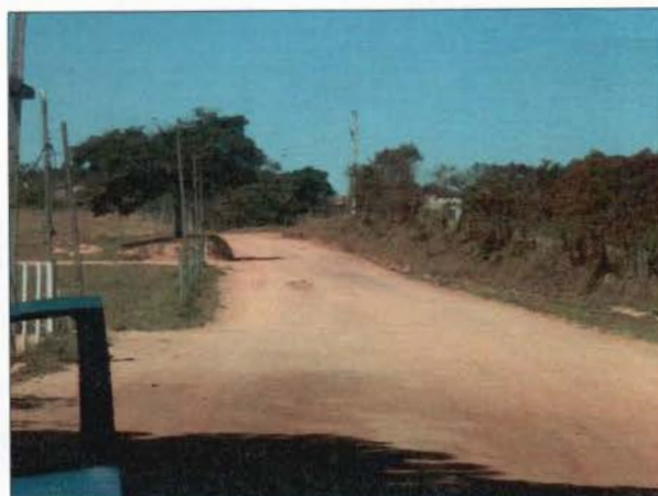
FIGURA 88 - VIA DESPROVIDA DE EQUIPAMENTOS DE DRENAGEM NA LOCALIDADE DE SÃO JOSÉ DAS NEVES (FONTE: ACERVO PESSOAL, 2014).
