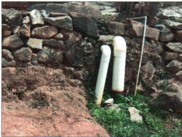
FIGURA 50 - REDE COLETORA DE ESGOTO NA SEDE MUNICIPAL - VISTA 1 (FONTE: ACERVO PESSOAL, 2014).
