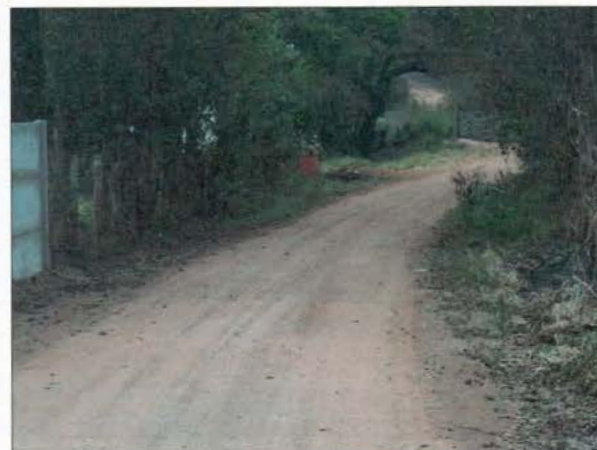
FIGURA 90 - VIA DESPROVIDA DE EQUIPAMENTOS DE DRENAGEM NA LOCALIDADE DE VARGEM ALEGRE (FONTE: ACERVO PESSOAL, 2014).
