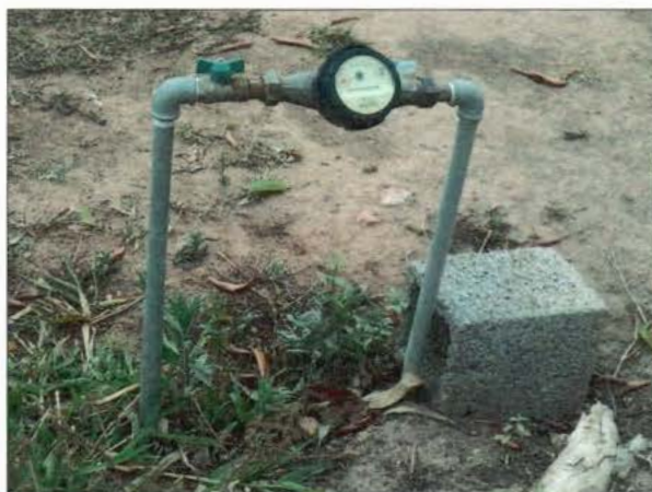
FIGURA 32 - HIDRÔMETROS NA LOCALIDADE PEDRA NEGRA (FONTE: ACERVO PESSOAL, 2014).
