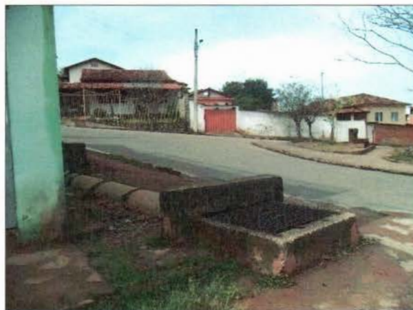
FIGURA 78 - BOCA DE LOBO NO DISTRITO-SEDE (FONTE: ACERVO PESSOAL, 2014).
