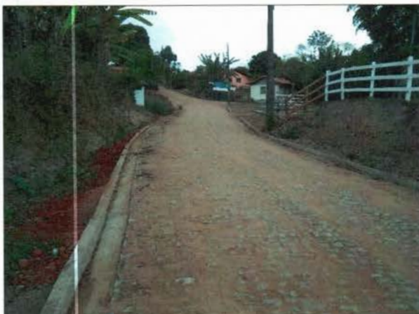
FIGURA 87 - VIA DESPROVIDA DE EQUIPAMENTOS DE DRENAGEM NA LOCALIDADE DE PEDRA NEGRA (FONTE: ACERVO PESSOAL, 2014).
