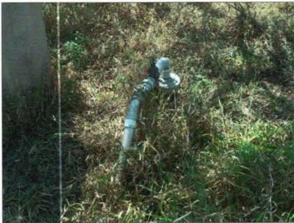
FIGURA 43 – CAPTAÇÃO SUBTERRÂNEA NA LOCALIDADE DE SÃO JOSÉ DAS NEVES - VISTA (FONTE: ELABORADO PELO AUTOR, 2014).
